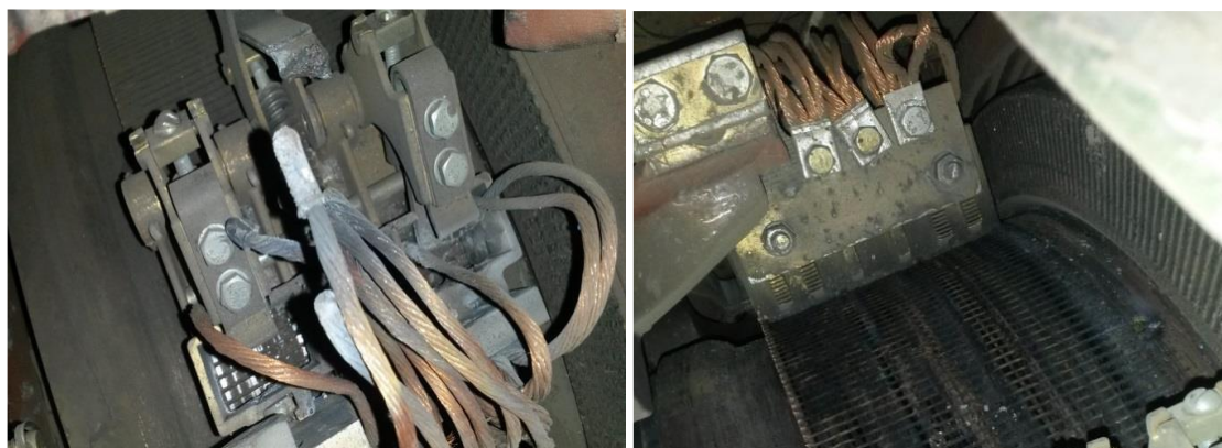
Рисунок 2.1 – Пробой по поверхности изолятора щеткодержателя
