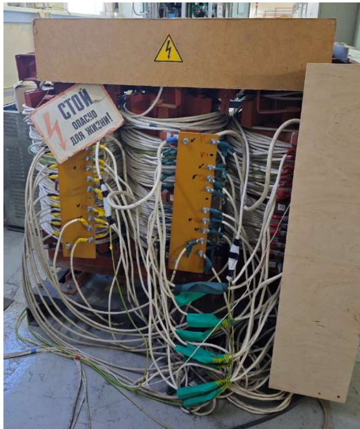
Рисунок 4.2 – Понижающий трансформатор типа ТСА-250 380/380 У/У-0 с дополнительными 18 обмотками 110 В
