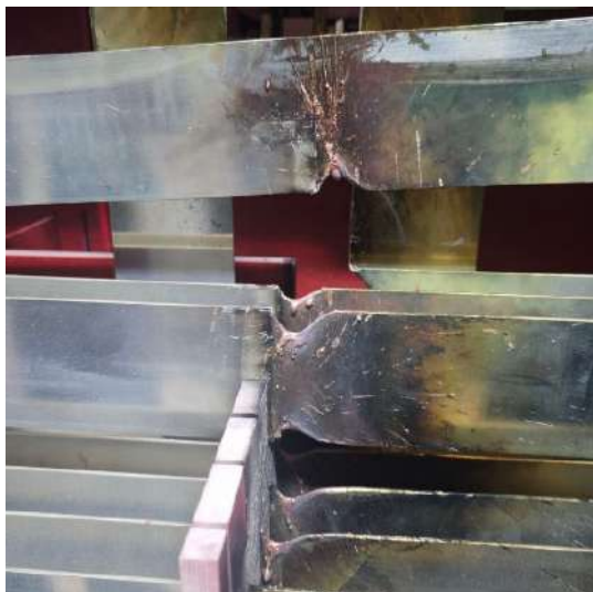
Рисунок 1.23 – Оплавление трехфазных питающих шин силовых ячеек при сложном междуобмоточном и междуфазном коротком замыкании согласующего силового трансформатора
