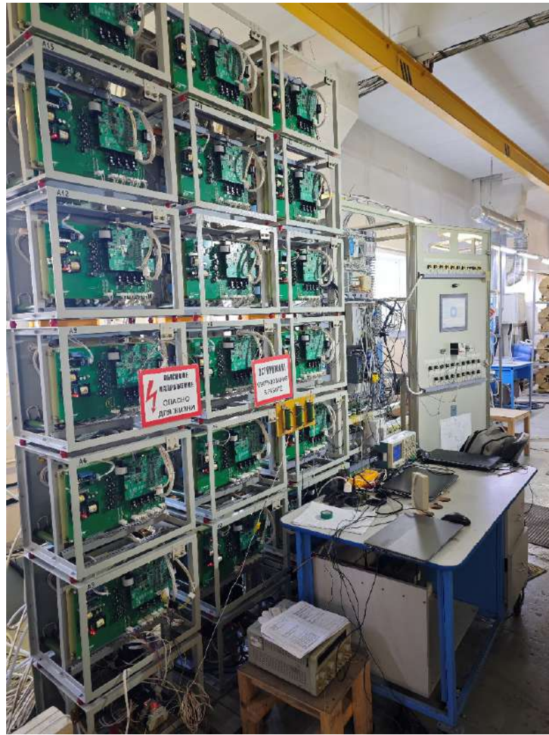
Рисунок 4.3 – Блоки силовых ячеек и ШУ адаптированной системы «ЭРАТОН-В» в составе экспериментального стенда
