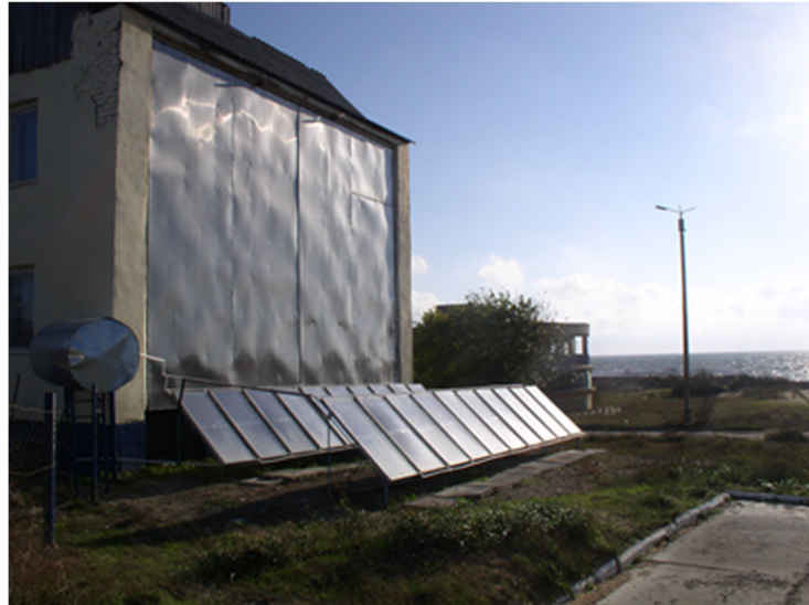
Рисунок 4.3 – Солнечные коллектора ( 20 \text{ м}^2 ) с теплоизолированным баком-аккумулятором для горячей воды
