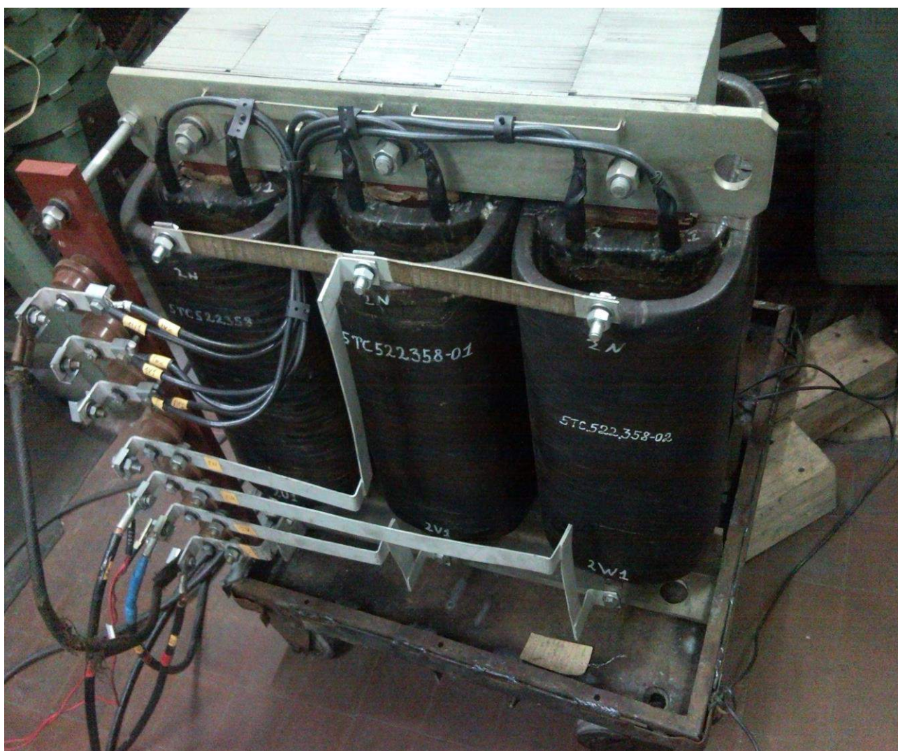
Рисунок 1.25 - Общий вид трансформатора Т-164.
